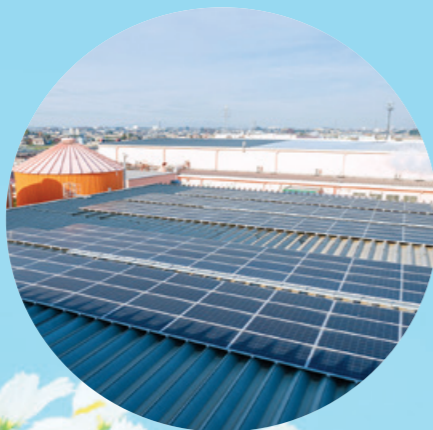
(株)日本キャンパック 利根川工場 太陽光発電設備
